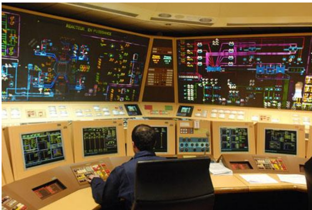
Photo 1 - Salle de commande de la centrale de Chooz (Ardennes). ©Alexandre Sargos/EDF Mediathèque
